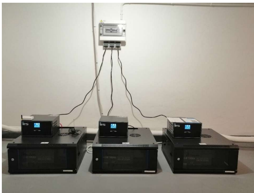
Zdj. Układ podtrzymania energii zapewniający zasilanie awaryjne lodówek, w których przechowywane są preparaty szczepionkowe magazynie PSSE w Rzeszowie
